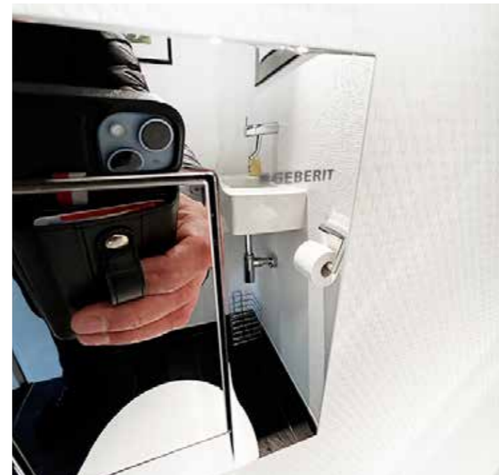
Die WC-Spül-Taster sind von der Firma „GEBERIT“
