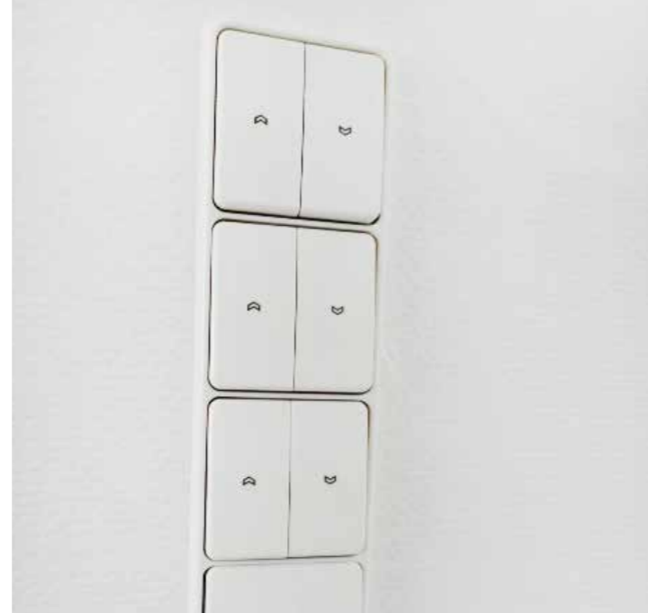
elektr. Rollläden im Wohnzimmer + Schlafzimmer
