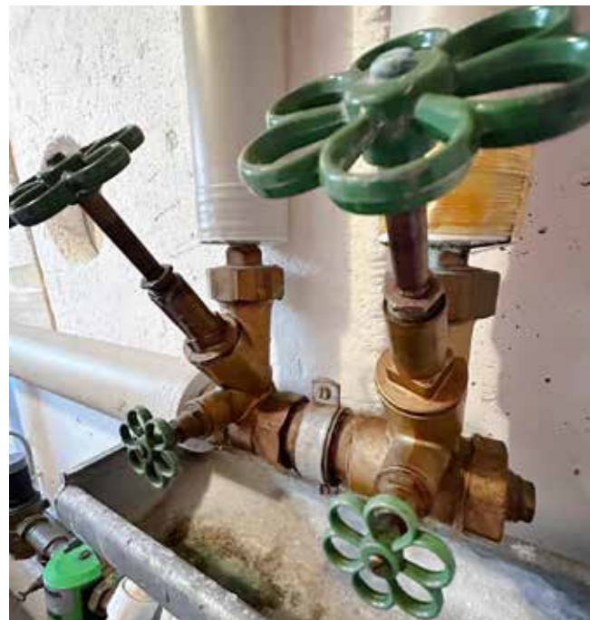
Sanitärinstallation in Kupfer
