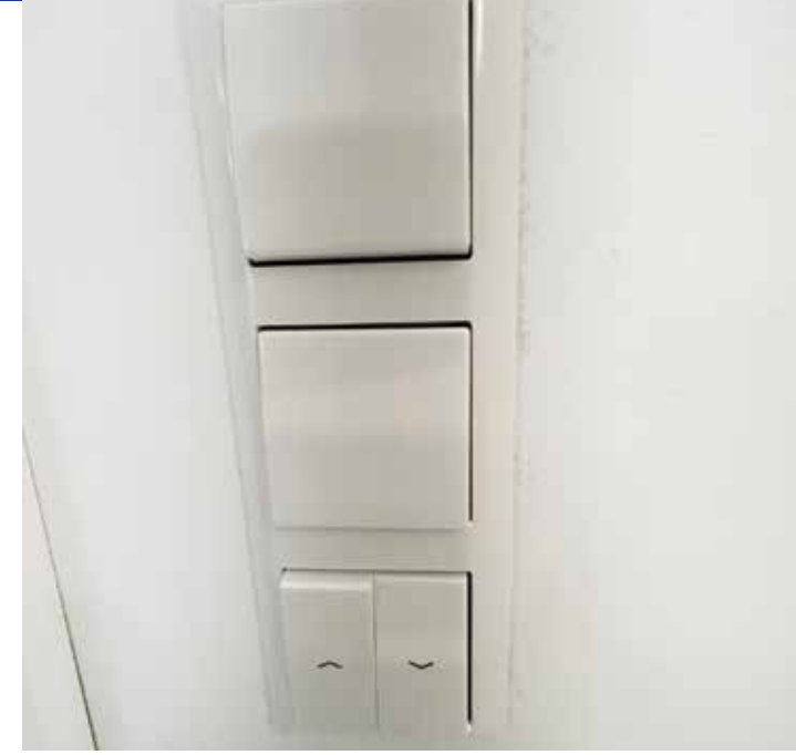
elektrische Rollladensteuerung in der gesamten Wohnung
