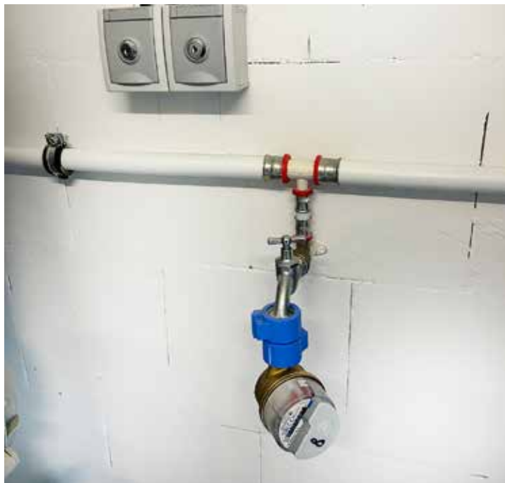
Anschluss im Keller für eine Waschmaschine
