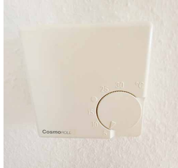
Steuerung der Fussbodenheizung
