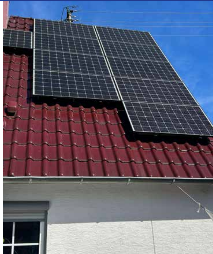
PV Anlage (9,76 kW/h)
