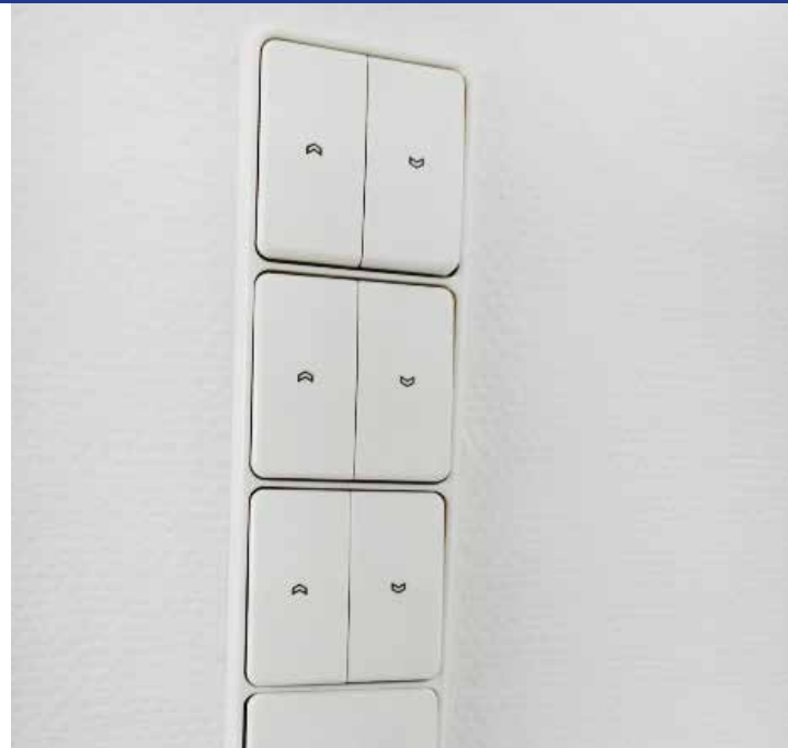
elektr. Rollladen im Wohnzimmer + Schlafzimmer
