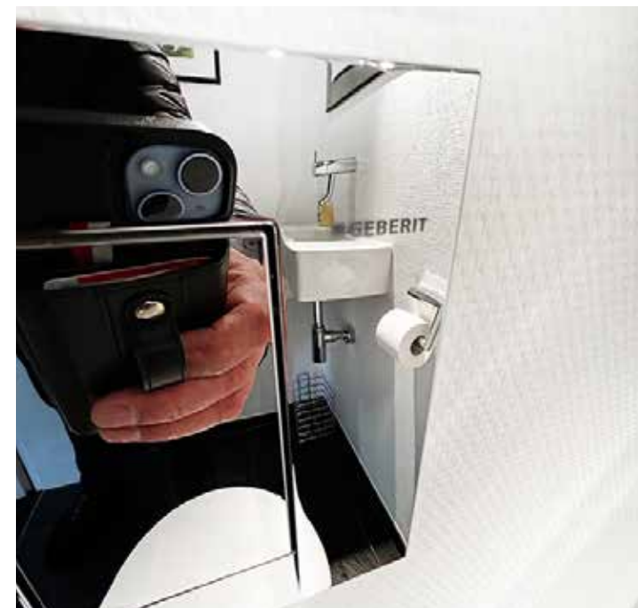
Die WC-Spül-Taster sind von der Firma „GEBERIT“
