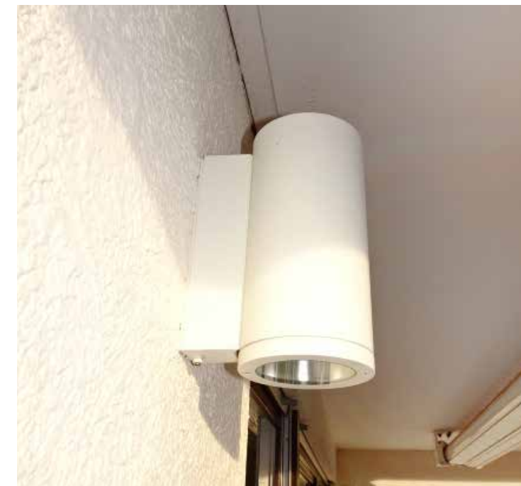
sehr hochwertige Aussenbeleuchtung auf der Dachterrasse (3 Senkrechtstrahler)
