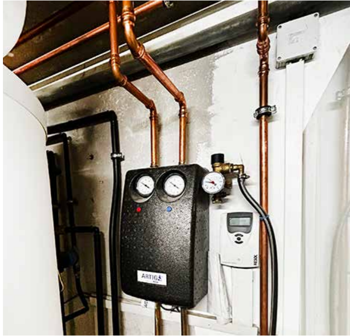
Sanitärinstallation in Kupfer
