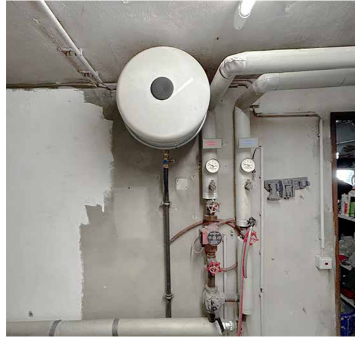
Vor- und Rücklauf Heizung
