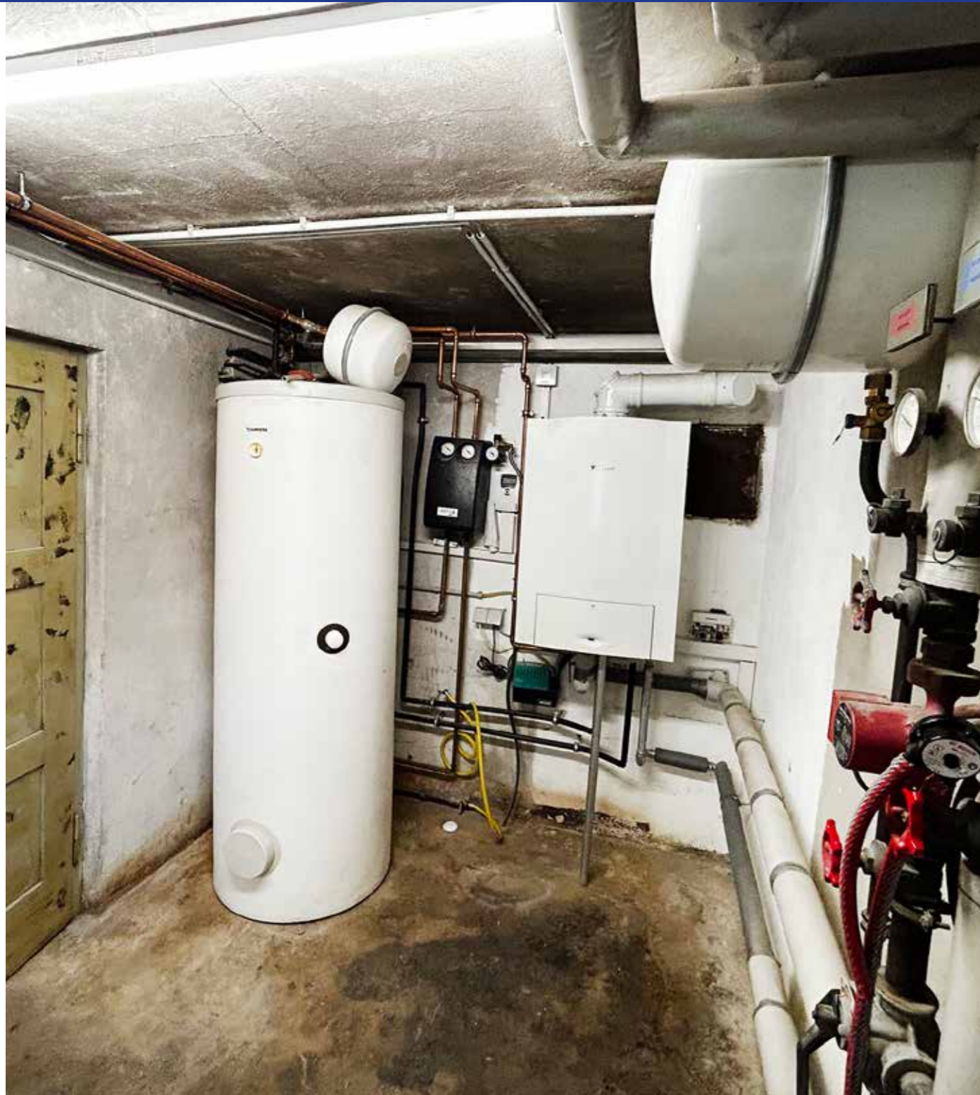
Heizraum im UG
