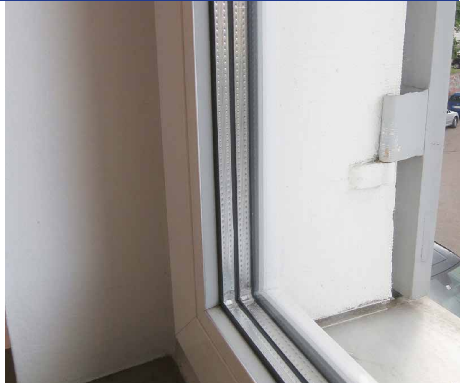
3-fach verglaste Fenster
