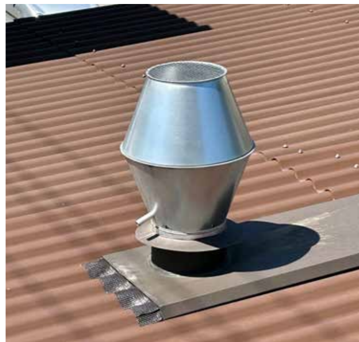
Dachentlüftung der Außenküche
