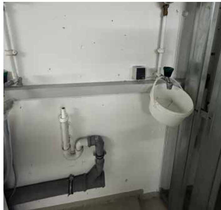
Waschmaschinenplatz in der Waschküche
