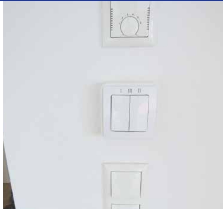
Heizung, Lüftung, Licht
