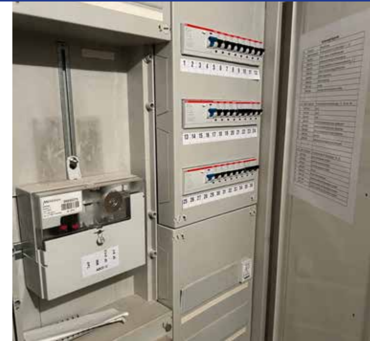
neuer Stromverteiler-Schrank im UG
