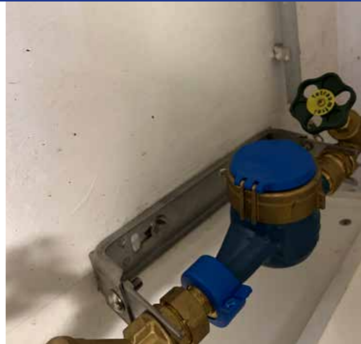
neuer Wasseranschluss im UG
