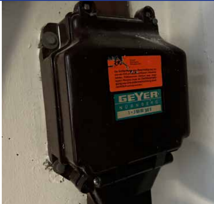
Hausstromanschluss im UG
