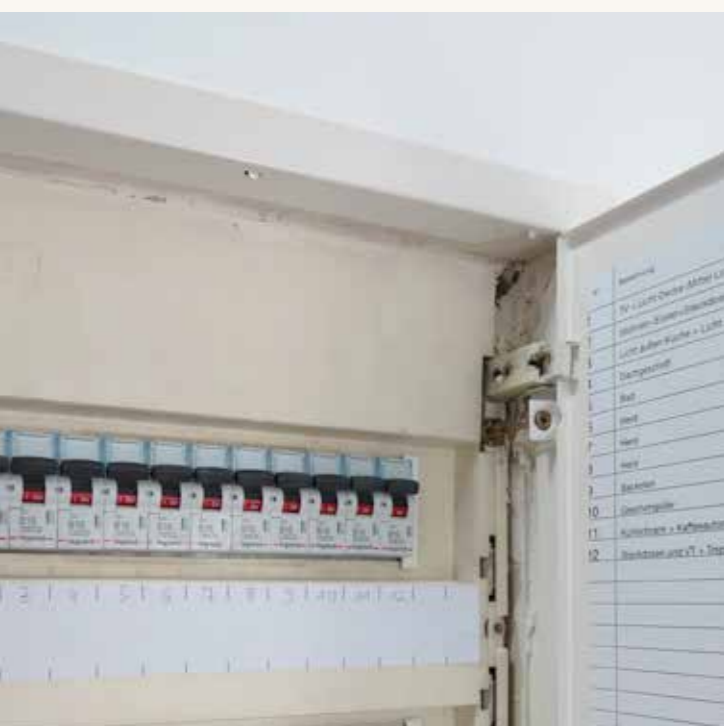
Sicherungskasten in der Wohnung Neu installiert nach den aktuellen VDE Vorschriften
