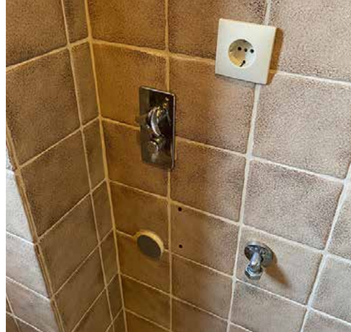
Waschmaschinenanschluß im Bad der ELW
