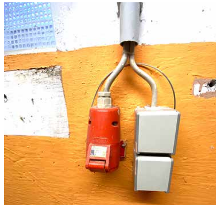
Starkstromanschluß im Keller / Werkstatt
